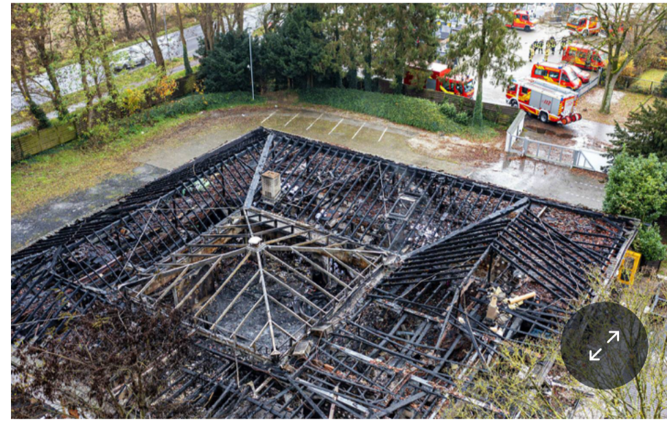
Am Morgen danach ein Blick aus der Luft auf die Einsatzstelle am Heidweg in Brüggens.
