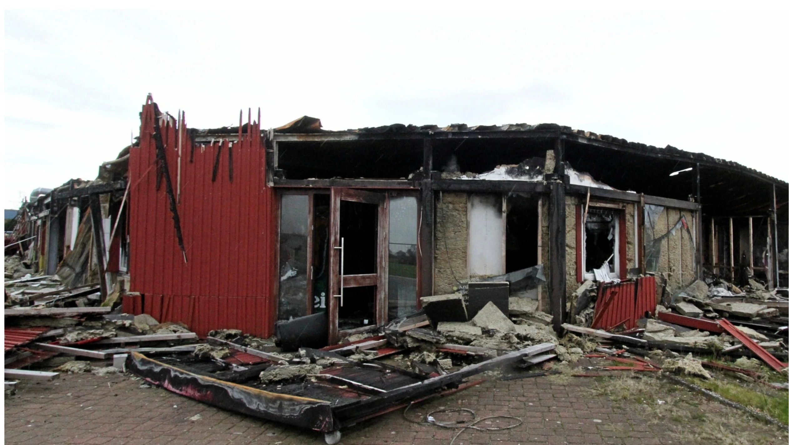
Bei einem Brand im FKK-Saunaclub in Hamminkeln blieb vom Gebäude nicht viel übrig. Ein Gast kam ums Leben. Ein Voerder steht deshalb vor dem Landgericht. © FUNKE Foto Services (archiv) | Gerd Hermann
