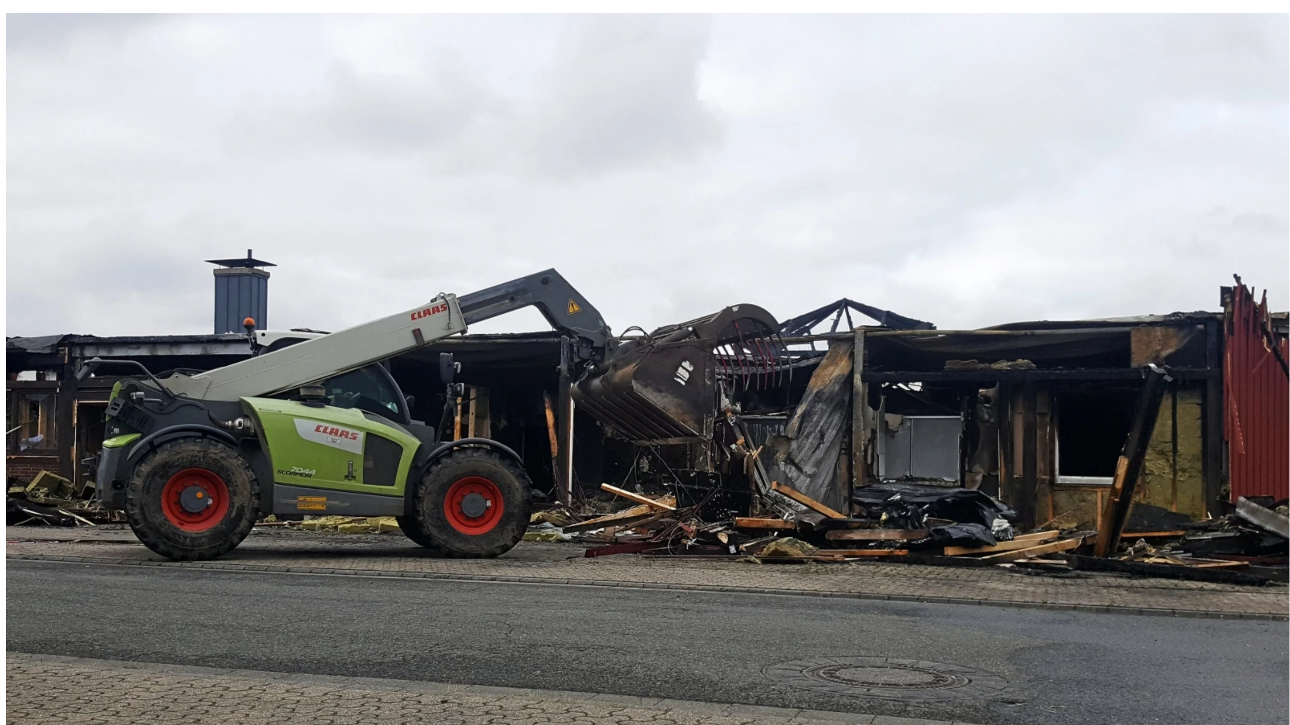
Obwohl die Feuerwehr bereits Teile der Fassade abgetragen hatte, entstanden in der Nacht noch Glutnester.
